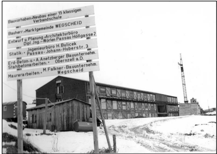
Von der Verbandsschule Wegscheid war im Winter 1965/66 nur der Längstrakt im Rohbau fertig. Der Querbau und der Sportbereich mit Hallenbad und Turnhalle folgten erst 1966. Foto: Schularchiv
